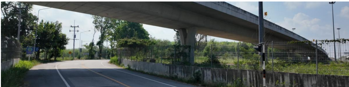
รูปที่ 6-12 สภาพทางหลวงหมายเลข 331 บริเวณ กม.10+250
